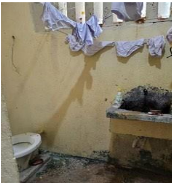
imagem 48 - Banheiro degradante de cela do pavilhão de trabalhadoras.
