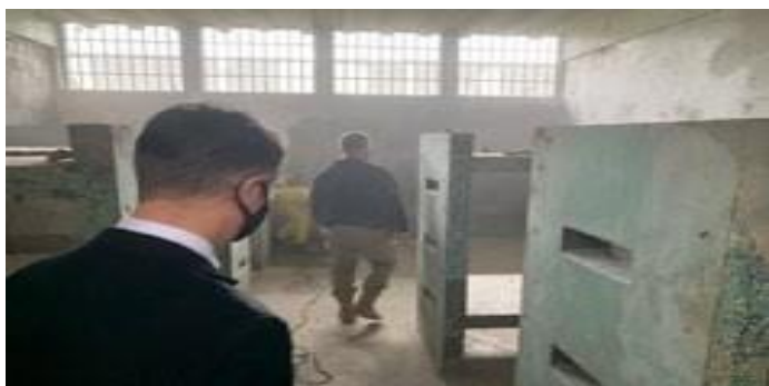
Imagem 24 - Cella em reforma no COMPAJ.
