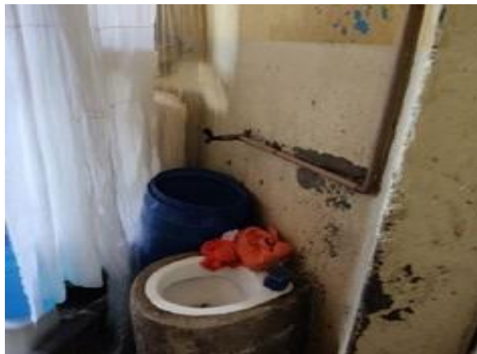
Imagem 44 - Banheiro em cela degradante do IPAT.
