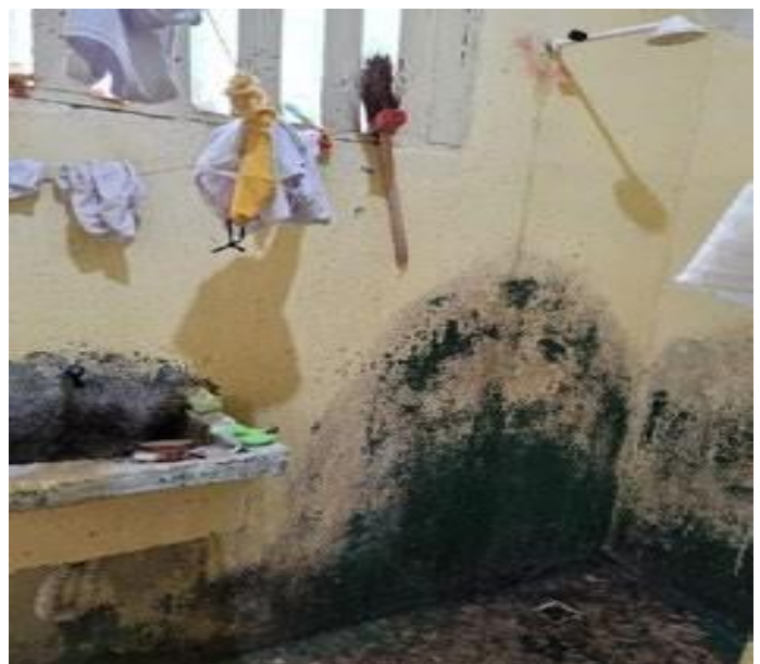
Imagem 49 - Banheiro degradante de cela do pavilhão de trabalhadoras.
