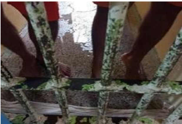
Imagem 33 - Chão de cela cheia de água no CDPM II.
