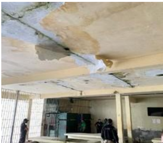
Imagem 18 - Infiltração no teto do COMPAJ.
