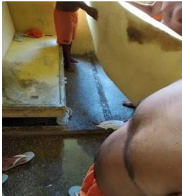
Imagem 42 - Internos mostram colchão degradante devido ao excesso de umidade em
